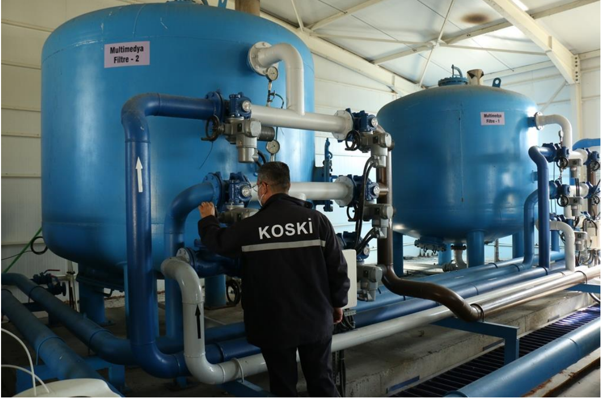
Resim 23. Konya Atıksu Geri Kazanım Tesisi
