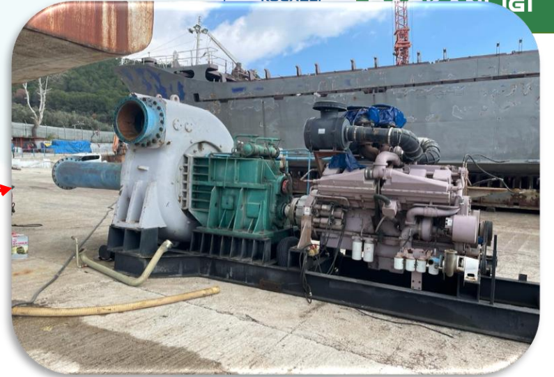
Çamurun terfisi için 2 adet booster pompa
