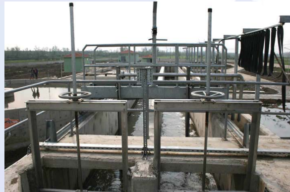
Adapazarı Büyükşehir Belediyesi'nin yaptığı arıtma tesisi
